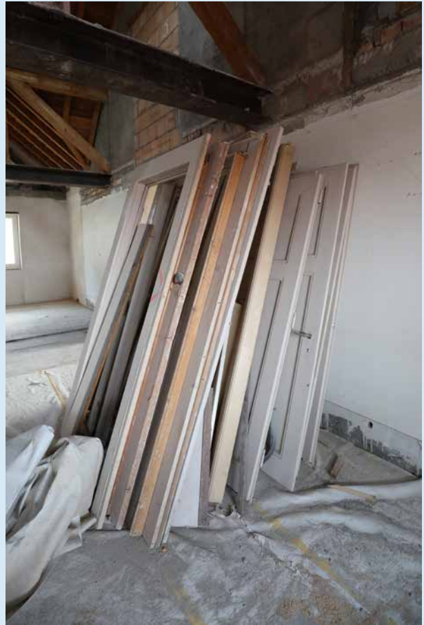
Menuiserie démontée en attente de rénovation
